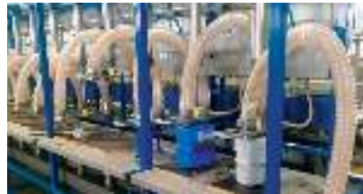
Газовая поверочная установка
